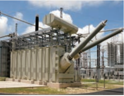
甲 变电站中的大型变压器
